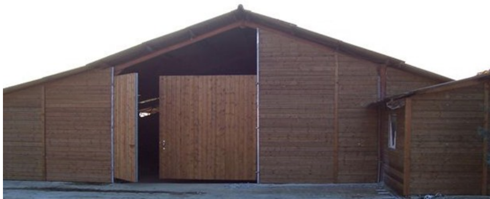
Bardage des pignons en bois ép. 22mm, installation d'un portail double battant
